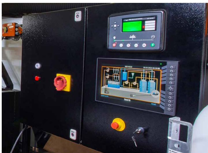
Übersichtliche Displays für die einfache Überwachung aller Vorgänge
